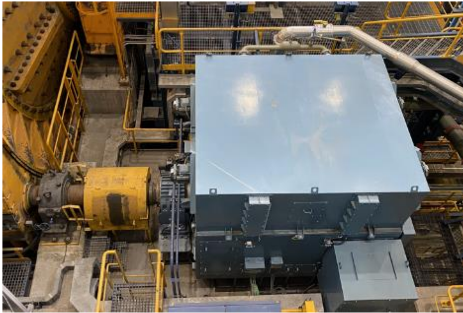
FIGURA 20: MOTOR DE ACIONAMENTO PRINCIPAL DO MOINHO AG/SAG
