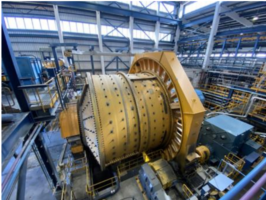
FIGURA 19: MOINHO AG/SAG INSTALADO EM NEVES-CORVO
