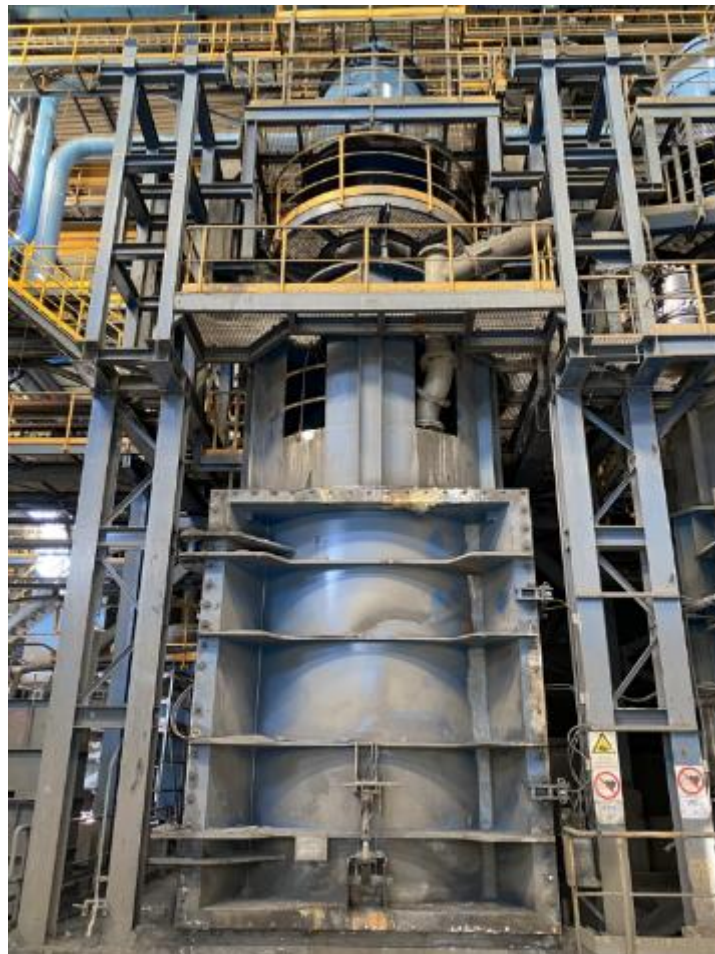
FIGURA 30: VERTIMILL INSTALADO EM NEVES-CORVO
